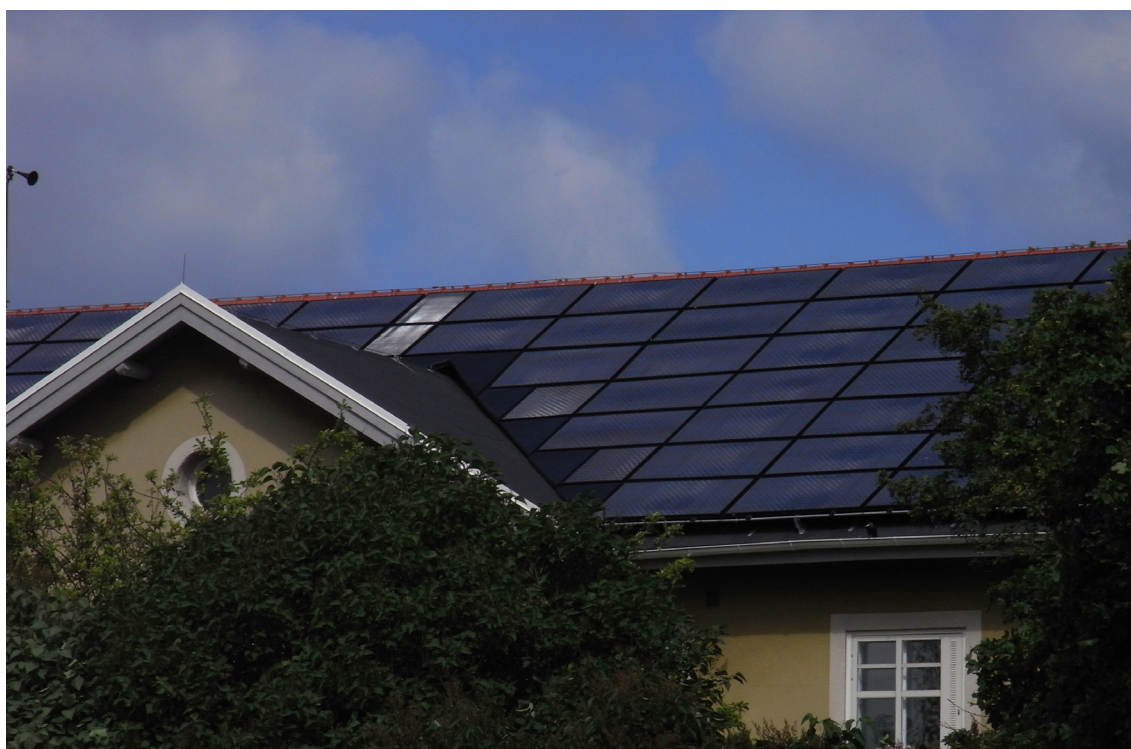
Takintegrerade solceller på en av de gamla vårdpaviljongerna (byggnad 4).
